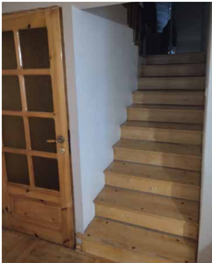
Zdjęcie 16. Brak poręczy utrudnia korzystanie ze schodów osobom z problemami ruchowymi Autor zdjęcia: A. Michalska.
